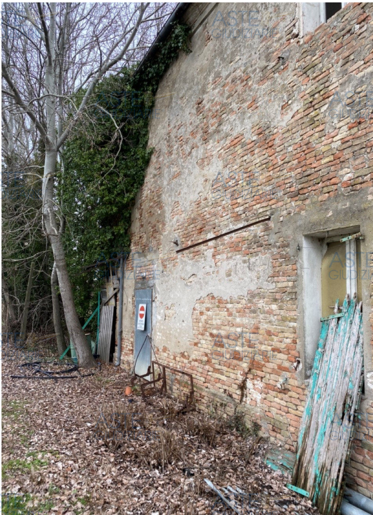
Fot. 15 - Dettaglio della facciata laterale. In evidenza lo stato di abbandono.
