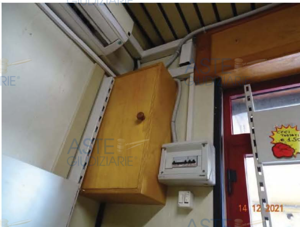
Foto 14 – Particolare quadro elettrico immobile “B”
