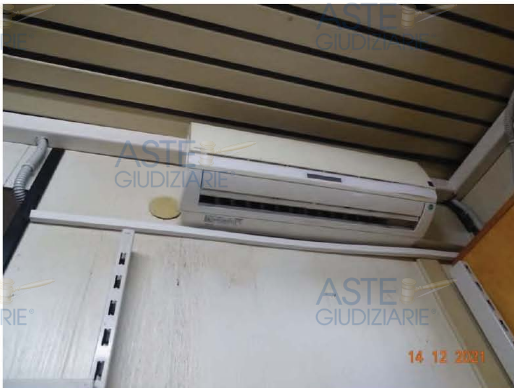
Foto 15 – Particolare del primo condizionatore immobile “B”
