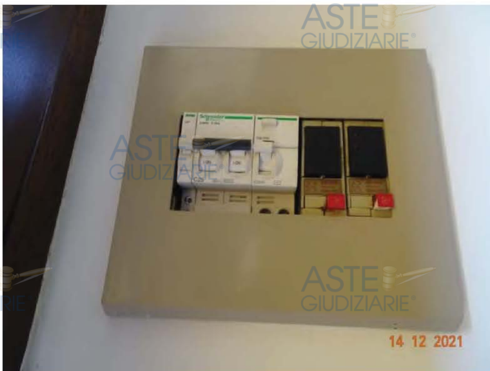
Foto 9 – Particolare Quadro Elettrico immobile "A"
