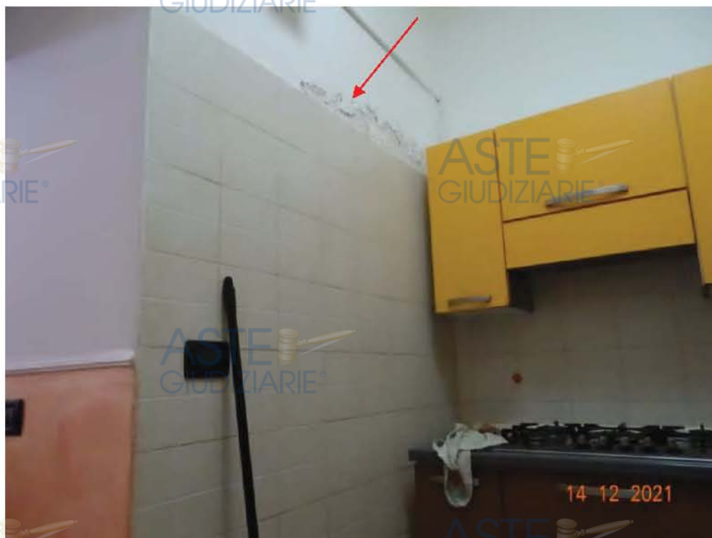
Foto 4 – Particolare cucina immobile “A” con evidenziata la presenza di umidità
