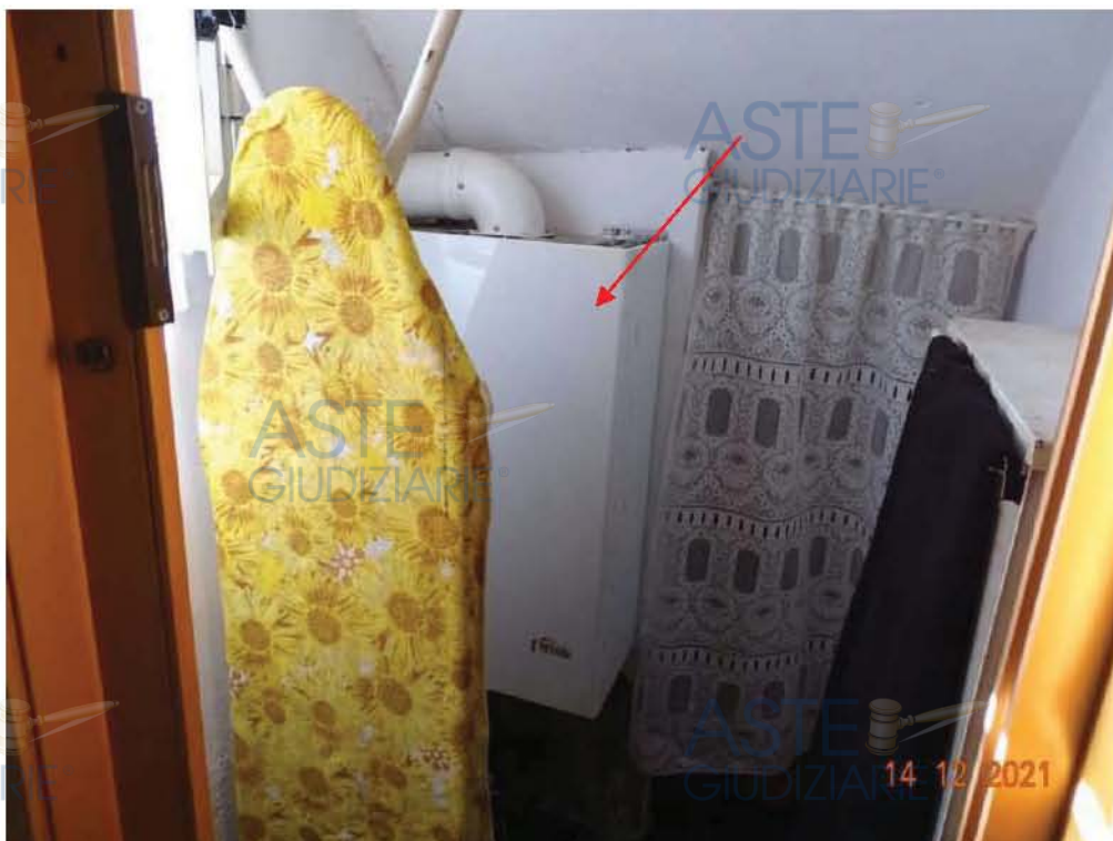
Foto 10 – Particolare caldaia posta nel sottoscala immobile "A"
