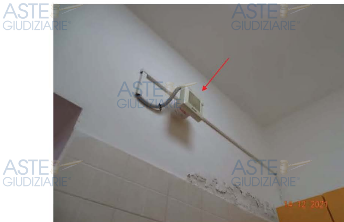
Foto 5 – Particolare della ventilazione forzata della cucina immobile "A"
