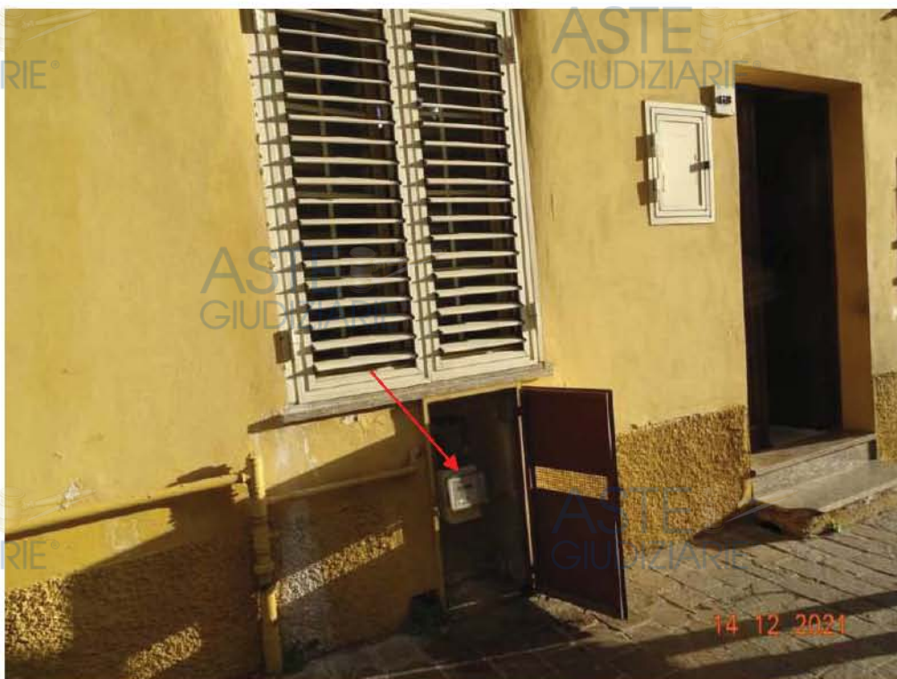
Foto 10 – Particolare vano misuratore Gas immobile “A”
