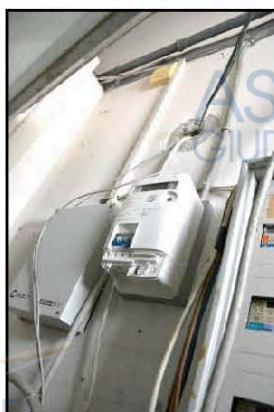
Figura 30 - Contatore energia elettrica – Subalterno 12
