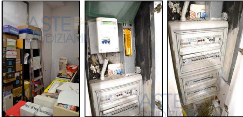
Figura 32 - Contatore energia elettrica – Subalterno 27
