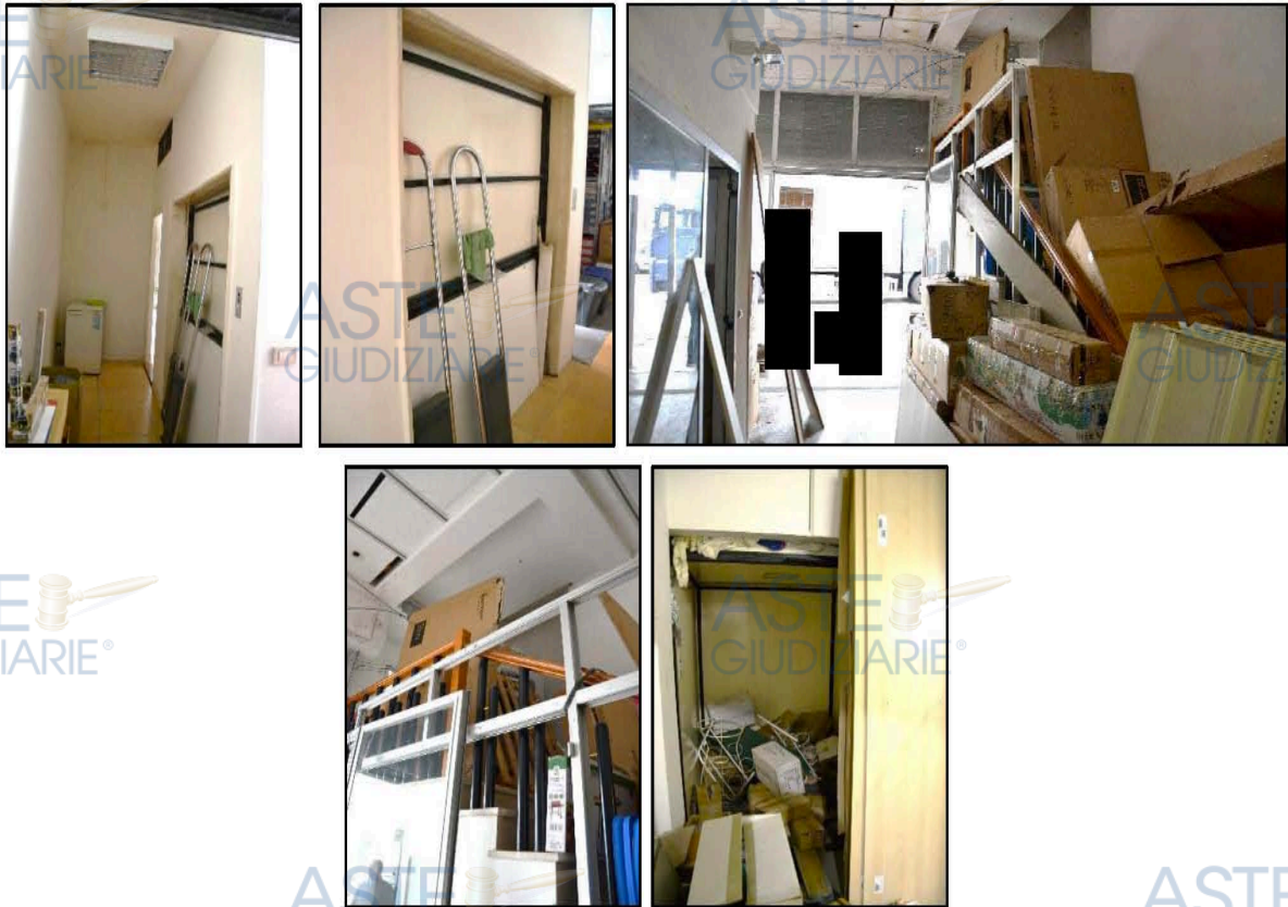
Figura 8 - Ascensore è dismesso ed il vano scala occluso
