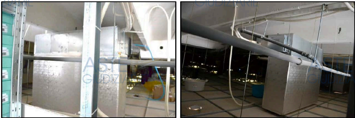
Figura 35 - Unità di trattamento aria
