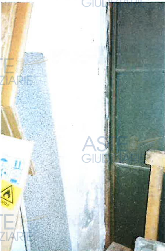
Foto 18: muro con umidità adiacente porta in ferro del magazzino
