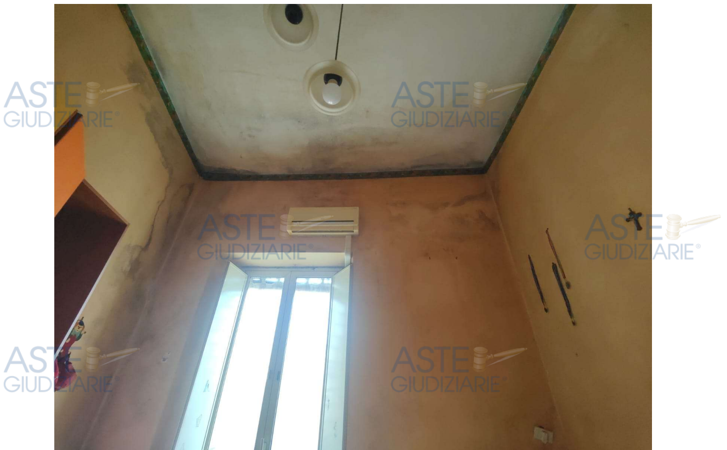
Fig. 17-18 – Soffitti in stato di degrado
