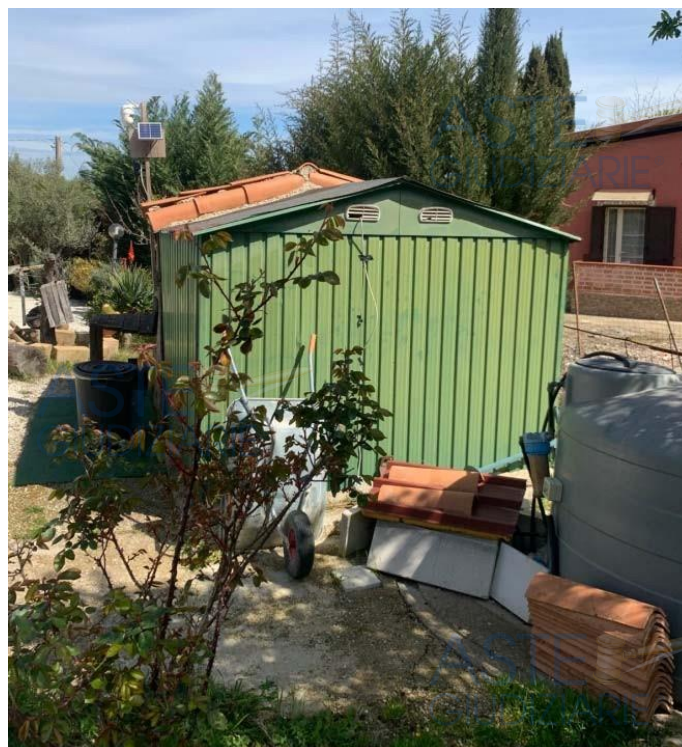
Foto 14 Locale tecnico in precario
