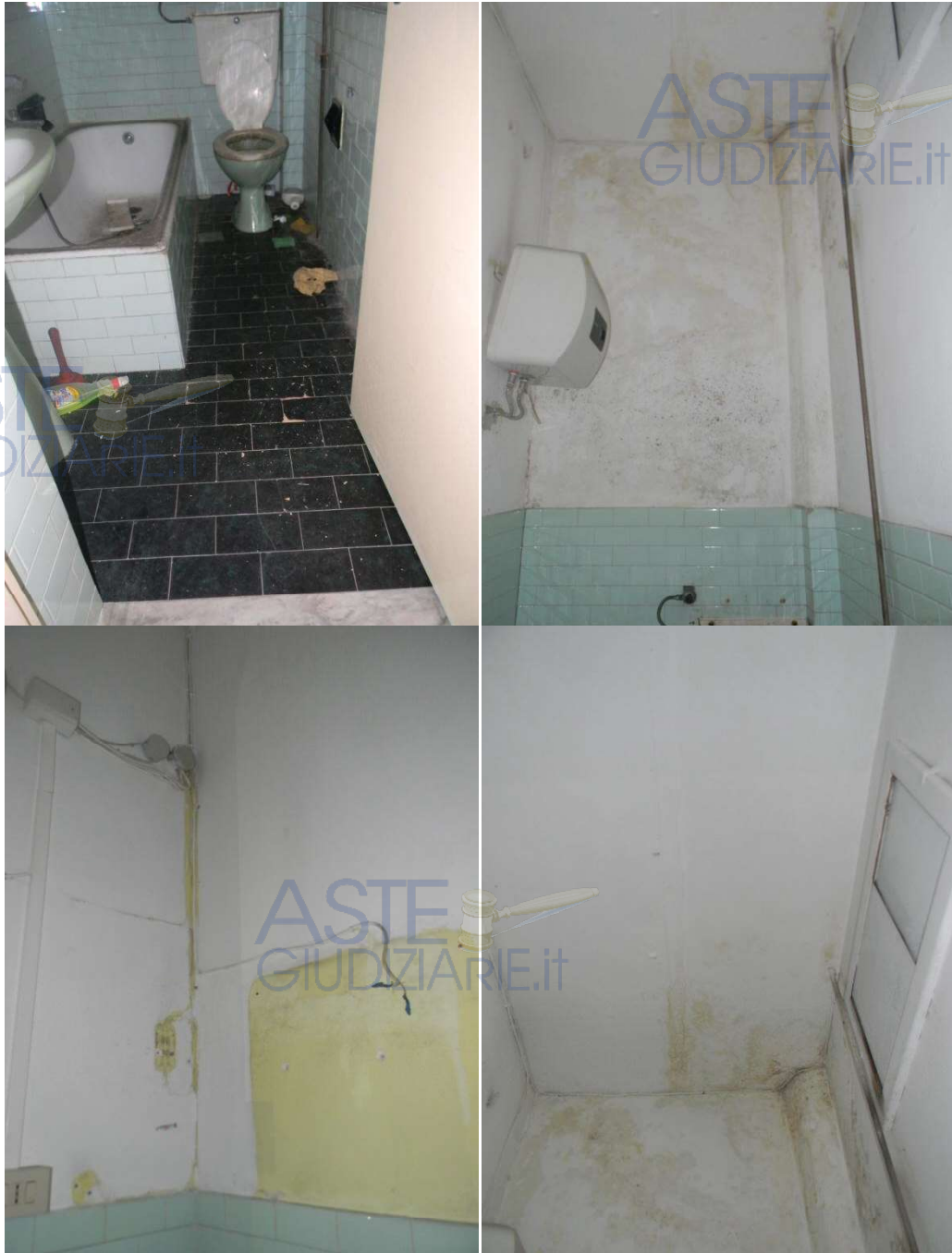
Foto 20: bagno al piano primo; sono evidenti le infiltrazioni d'acqua e l'impianto elettrico non a norma
