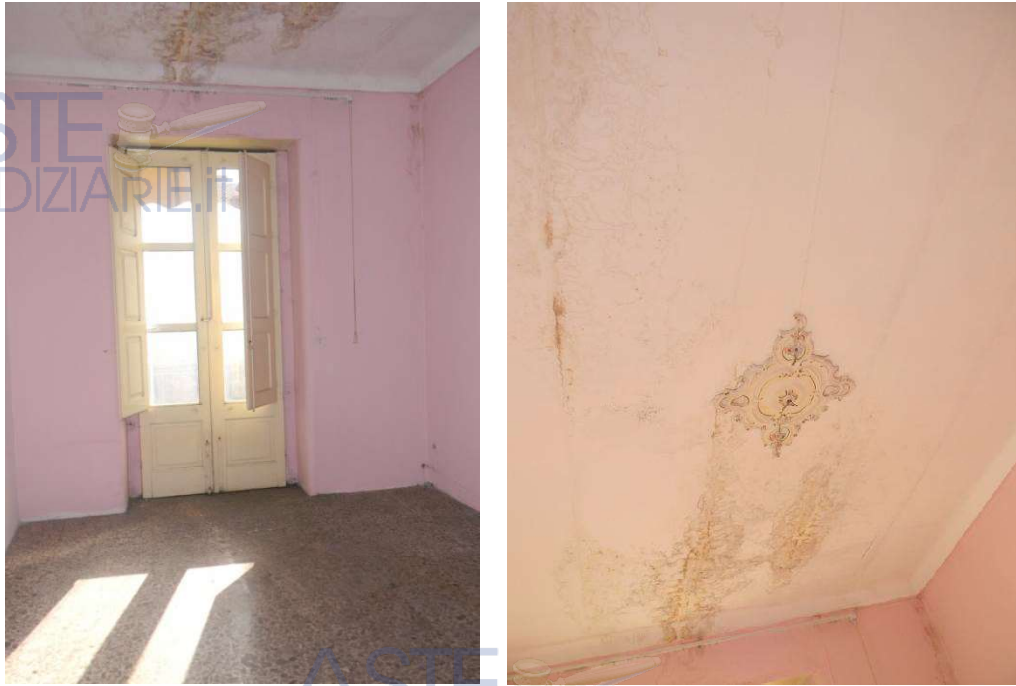
Foto 15: vano al primo piano con affaccio su via Cavour; particolare del soffitto con in evidenza le infiltrazioni d'acqua presenti
