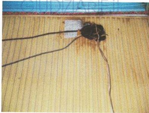
impianto elettrico, con cavi elettrici vecchi e non a norma
