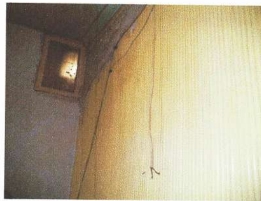
impianto elettrico, con cavi elettrici vecchi e non a norma
