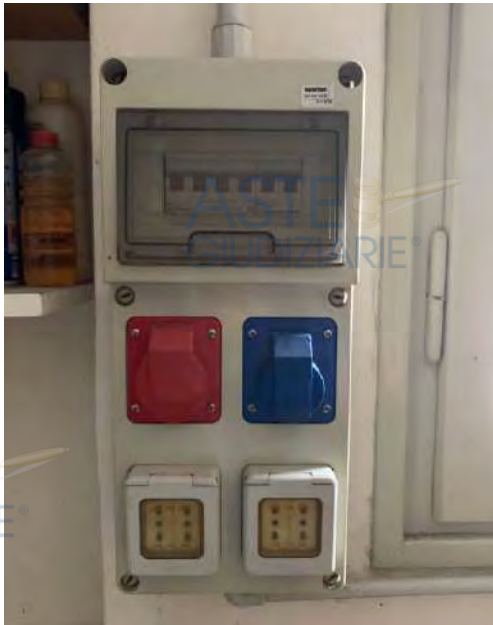
Quadro elettrico principale
