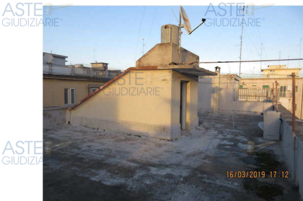
Foto n.38 Precarie condizioni del lastrico solare e della guaina
