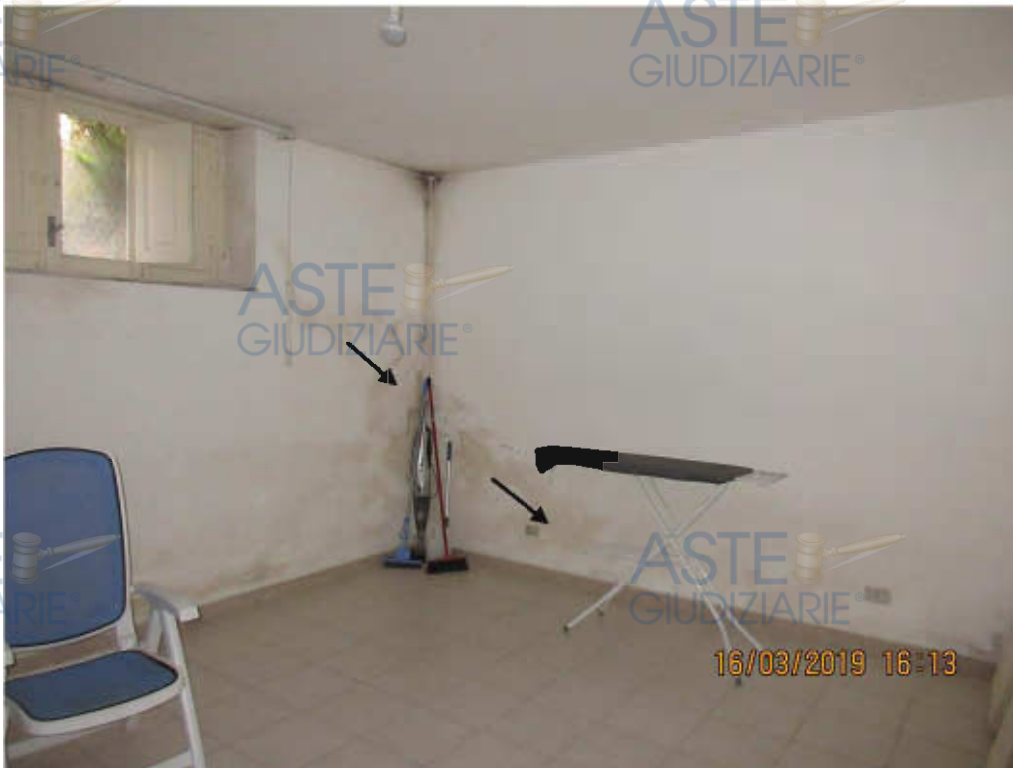
Foto n. 27 Tracce di Fenomeni di infiltrazioni di acqua
