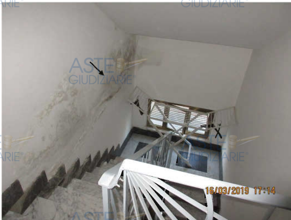
Foto n.35 Fenomeni di infiltrazioni di acque sulle pareti del vano scale di collegamento tra il piano rialzato ed il lastrico solare.
