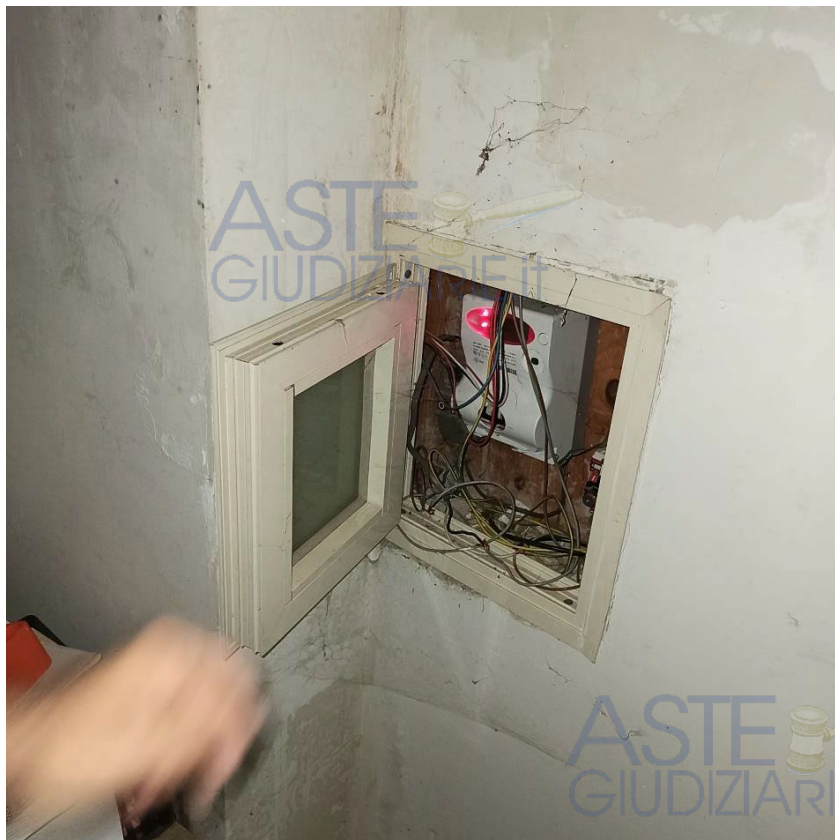
Foto n.04 - fornitura ENEL al piano terra dell'immobile negozio (foto da sopralluogo del 30/04/2024)
