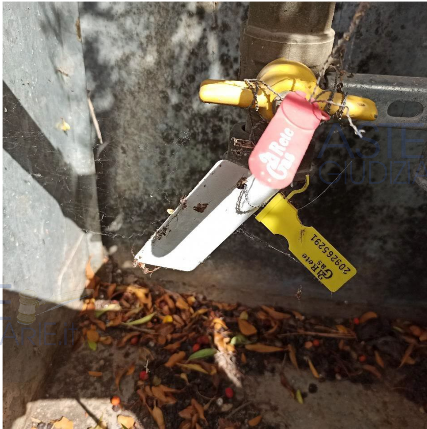
Foto n.05 - fornitura GAS - ubicata all'interno del Bene n. 2 - area urbana foglio 15 part. 1294 sub 1 - (foto da sopralluogo del 30/04/2024)
