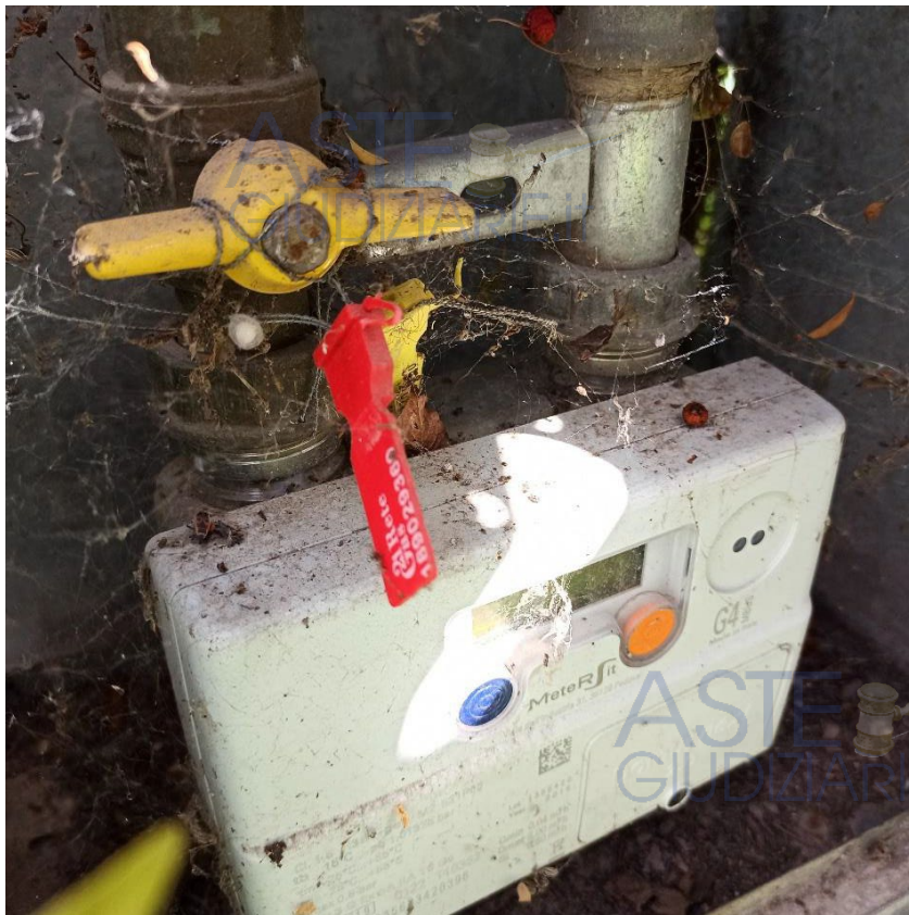
Foto n.06 - fornitura GAS - ubicata all'interno del Bene n. 2 - area urbana foglio 15 part. 1294 sub 1 - (foto da sopralluogo del 30/04/2024)
