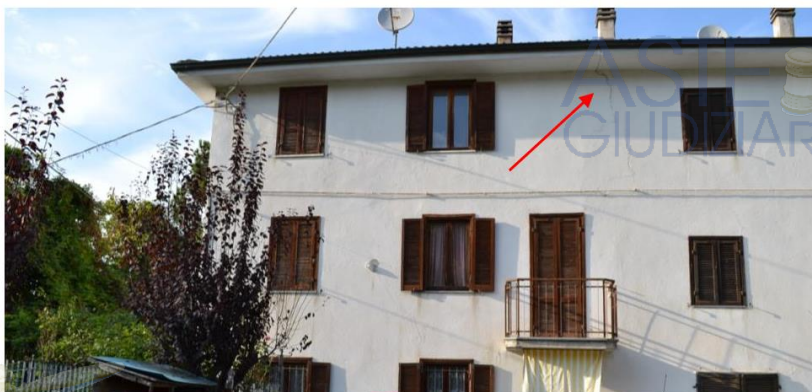
Foto 8: Individuazione della fessurazione su facciata
