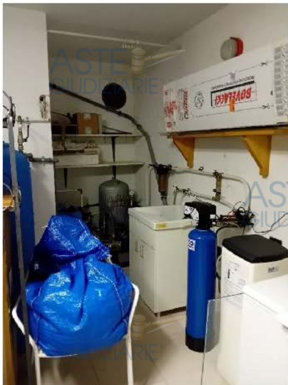
centrale idrica di distribuzione ( piano interrato)
