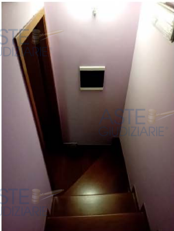
quadro elettrico generale
