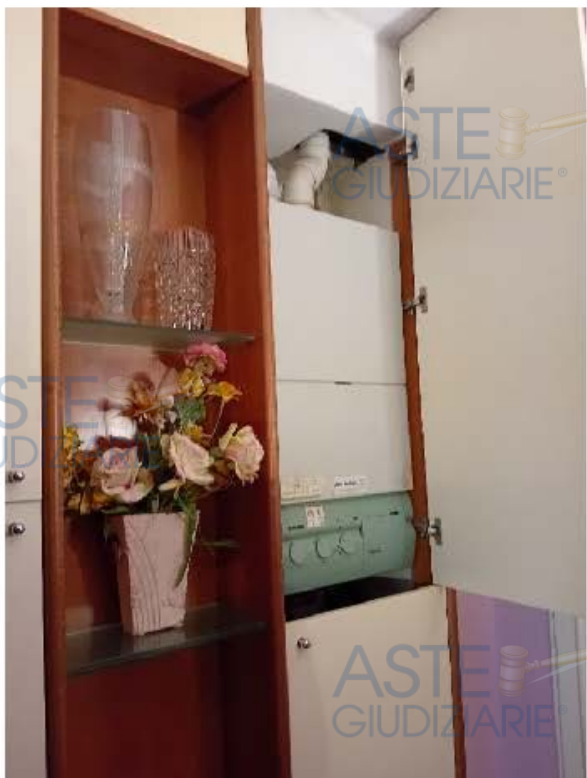
caldaia posta nel disimpegno al piano terra
