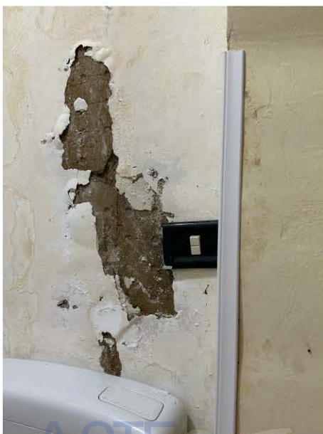
Infiltrazioni bagno piano terra
