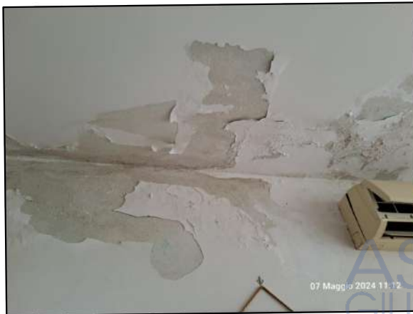
piano terzo - soffitto - tracce di umidità
