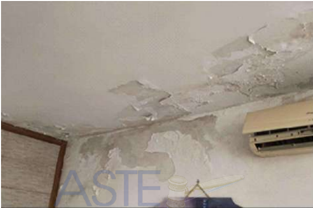
piano terzo - soffitto - tracce di umidità
