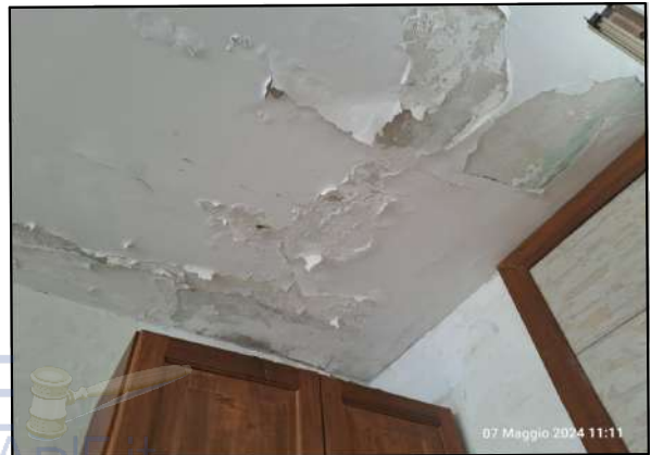
piano terzo - soffitto - tracce di umidità
