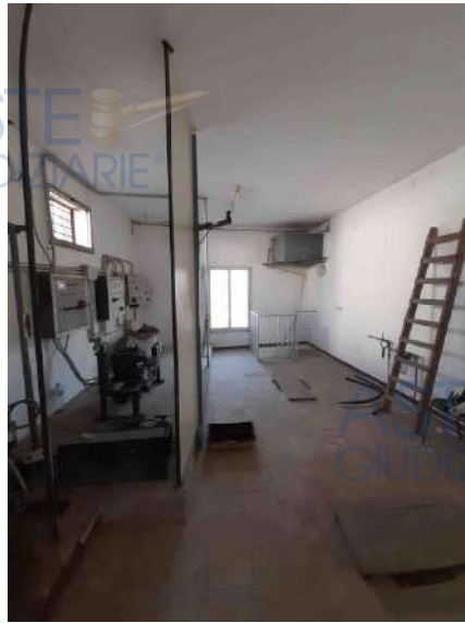
Foto 25 – Locale Tecnico (LT)
