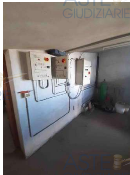
Foto 36 – Locale Tecnico (LT)
