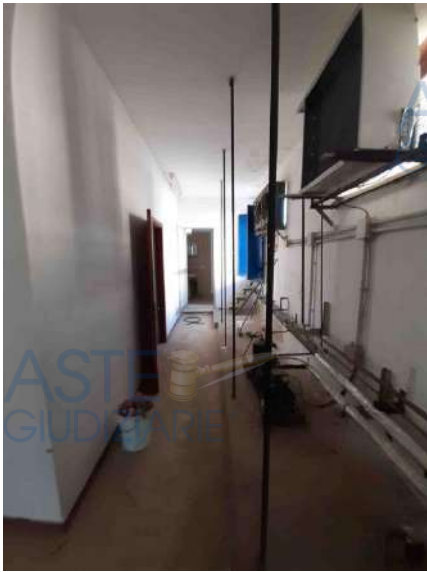
Foto 24 – Locale Tecnico (LT)
