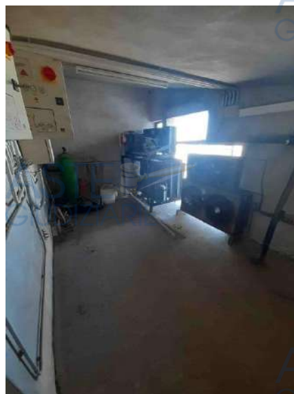
Foto 34 – Locale Tecnico (LT)
