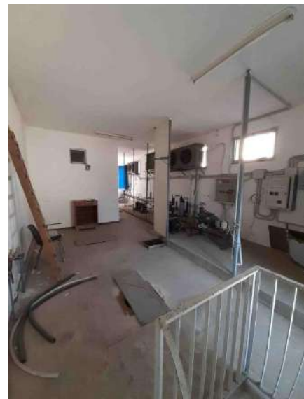
Foto 23 – Locale Tecnico (LT)
