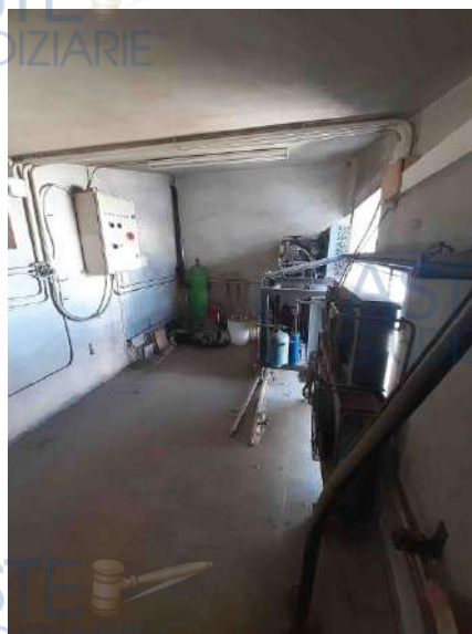
Foto 35 – Locale Tecnico (LT)
