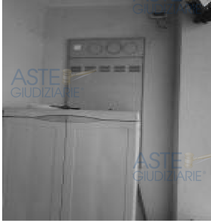
caldaia murale esterna a gas metano a scomparsa
