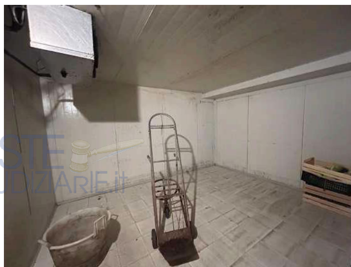
Cella frigorifera - p. interrato
