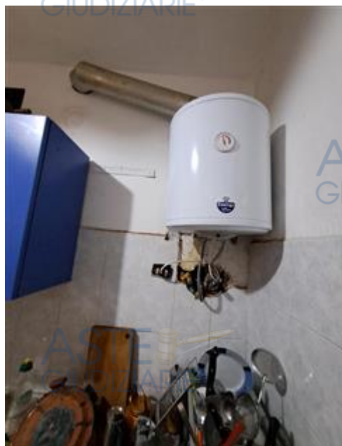
Boiler elettrico (vano ex ingresso)
