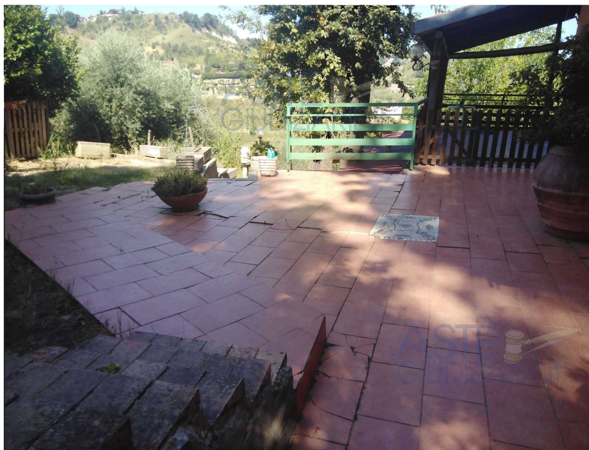
pavimentazione esterna particolare dissesto del terreno di fondazione
