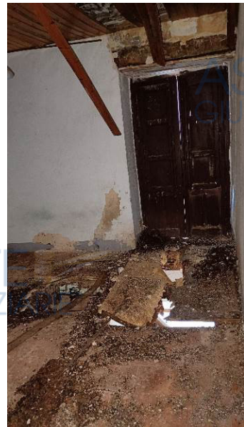
Solaio di interpiano crollato camera 3 primo piano
