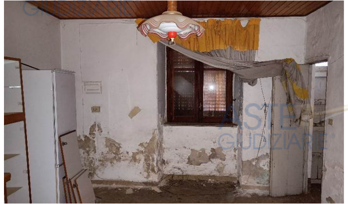
Umidità di risalita soggiorno 4 piano terra
