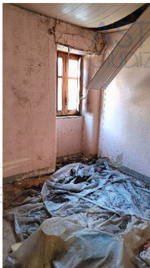
Controsoffitto crollato camera 3 secondo piano
