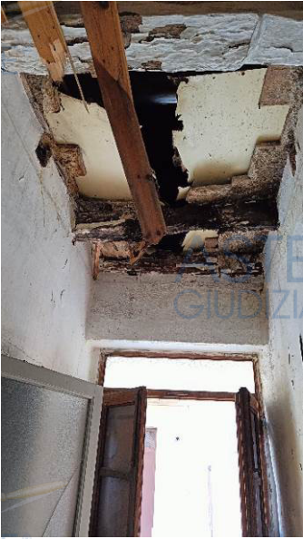
Travi e solaio ammalorate zona ingresso 1 piano terra
