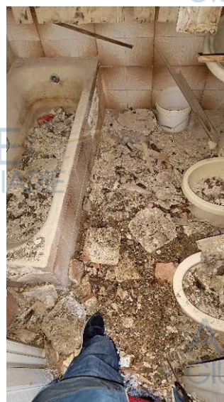
Distacchi di intonaco dal soffitto del w.c. 3 piano terra
