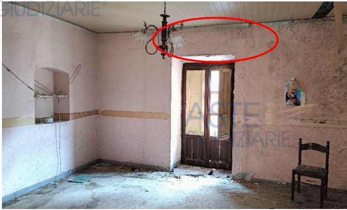
Lesioni nella muratura portante camera 2 secondo piano (lato interno)
