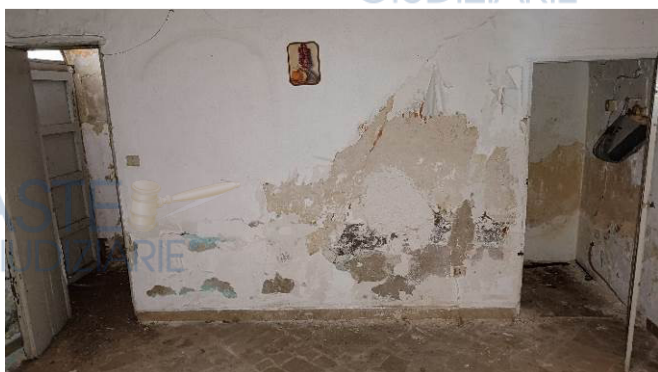
Umidità di risalita Soggiorno 4 e ripostiglio 5 piano terra
