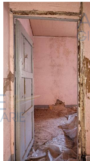
Lesioni nella muratura portante camera 3 secondo piano
