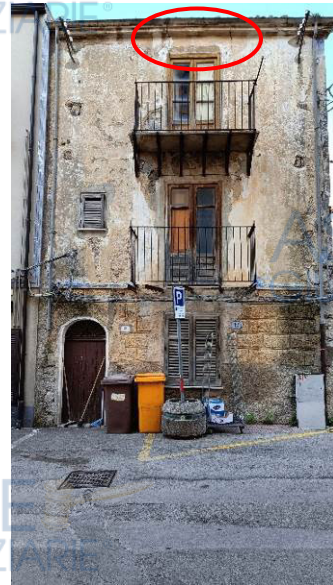
Lesioni nella muratura portante camera 2 secondo piano (lato esterno)
