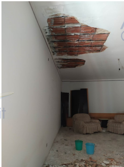
Sfondellamento del solaio del salone
