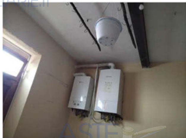
P.T. cantina: vista delle caldaie
