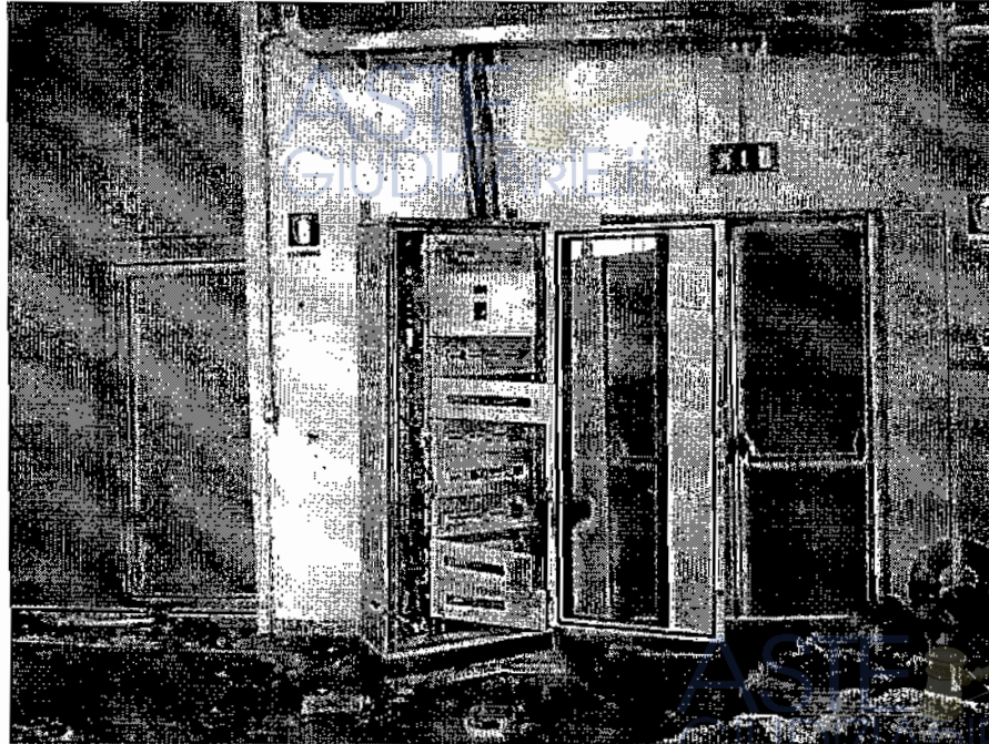
Fotografia n. 28 – Particolare quadro elettrico all'interno del capannone.
