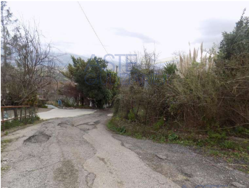
Fig.re 36-37: via Volpaio ove ubicato il Lotto Due, tale strada è che conduce al compendio pignorato e risulta essere tortuosa per effetto del manto di asfalto non curato.
