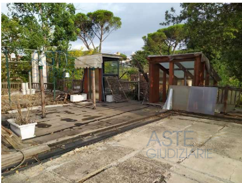
Lo stato di manutenzione della terrazza sovrastante l'ingresso al piano terra del ristorante in data antecedente al deposito dell'elaborato peritale
