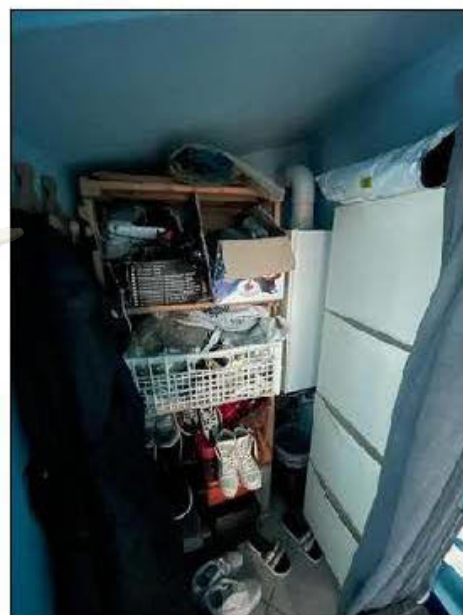
FOTO 10: RIPOSTIGLIO DOVE È ALLOGGIATA LA CALDAIA
