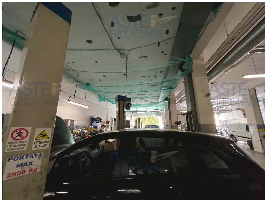
Porzione solaio sfondellata e messa in sicurezza
