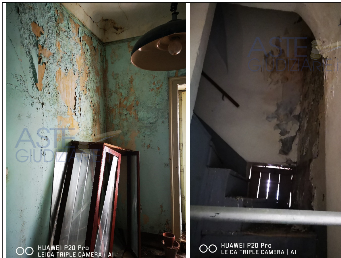
Foto n.8 : Alcuni pinti infiltrazione acqua piovana
