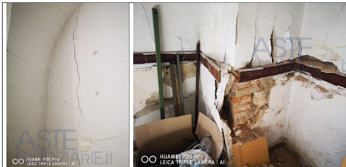
Foto n.20: Deposito – sub. 4 – Lesioni e distacchi intonaco
