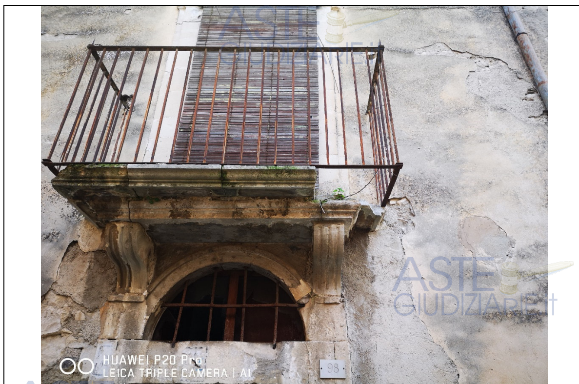
Foto n.9: Balcone deteriorato – Locale 1
