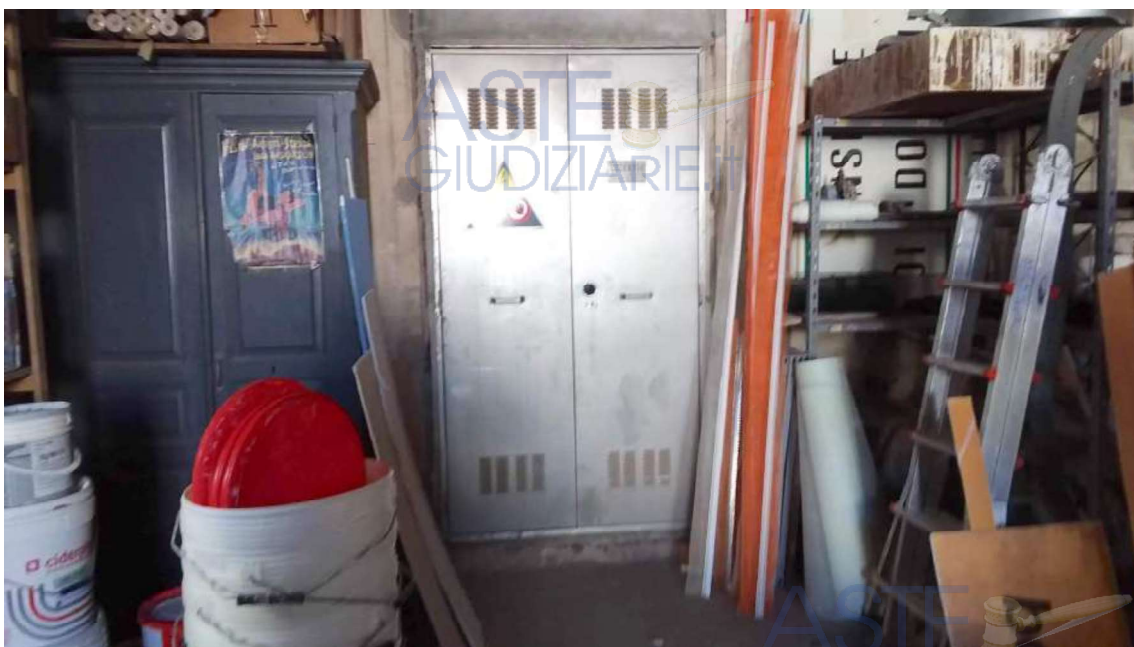
Foto 7 Lotto 2 Accesso alla cabina Enel dal magazzino cat. C2 particella 121 sub 1 Ragusa Foglio 50
