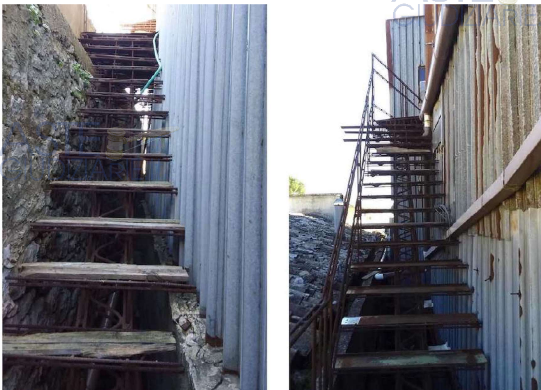
Foto 71 e 72 Lotto 2 Accesso esterno dal piano terra di Via Ungaretti all'unità in corso di costruzione F3 a piano secondo, particella 121 sub 25 Ragusa Foglio 50
