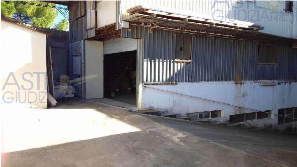
Foto 30 Lotto 2 Accesso dalla Via Ungaretti al laboratorio cat. C3 a piano terra, particella 121 sub 2 Ragusa Foglio 50
