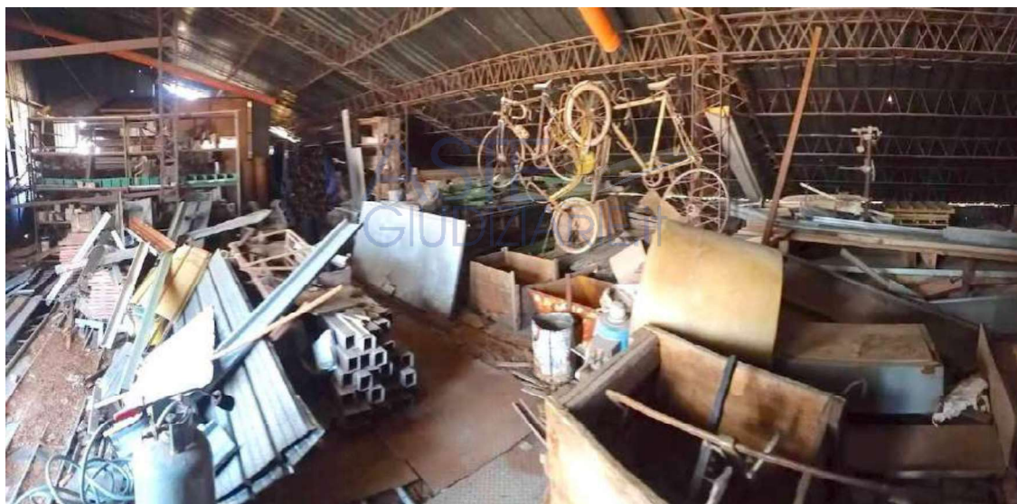
Foto 79 Lotto 2 Interno Unità in corso di costruzione F3 a piano secondo, particella 121 sub 25 Ragusa Foglio 50
