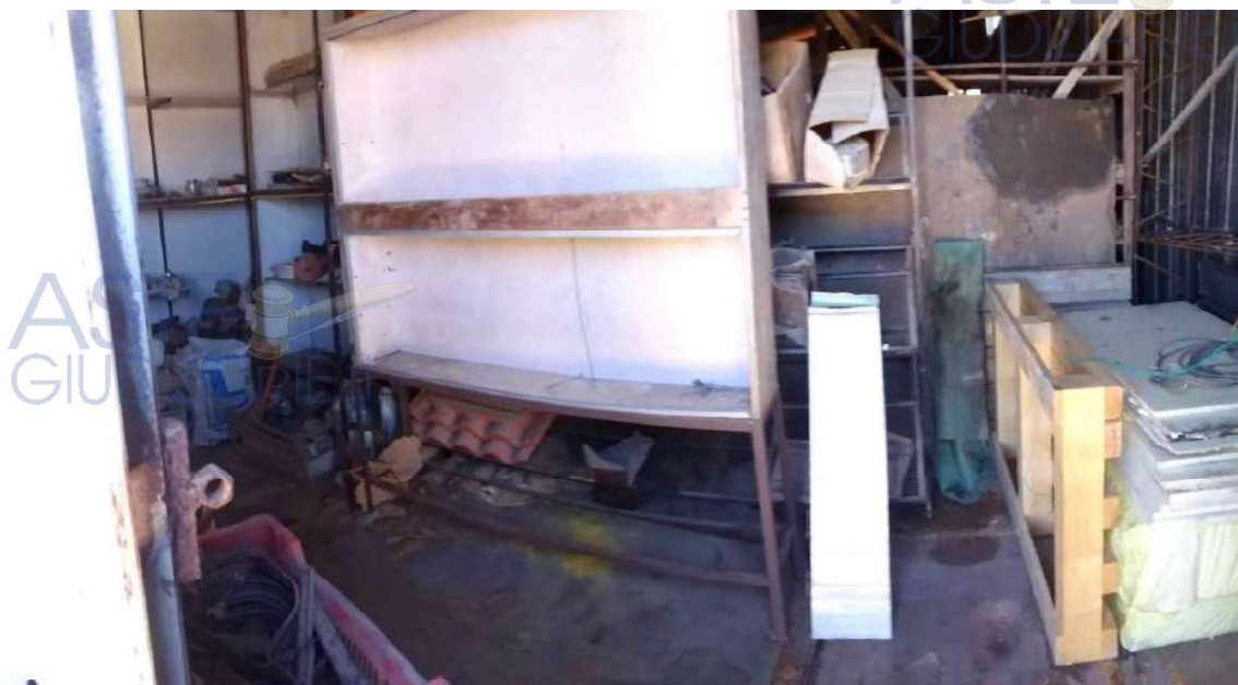
Foto 76 Lotto 2 Interno Unità in corso di costruzione F3 a piano secondo, particella 121 sub 25 Ragusa Foglio 50
