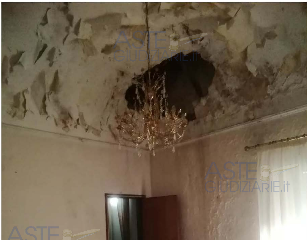
Foto 03. Vano con parziale controsoffitto crollato
