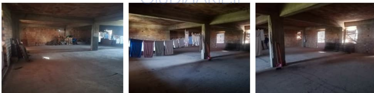
Vista interna del bene 2, u.i. in corso di costruzione (riproduzione completa in All.03c).
