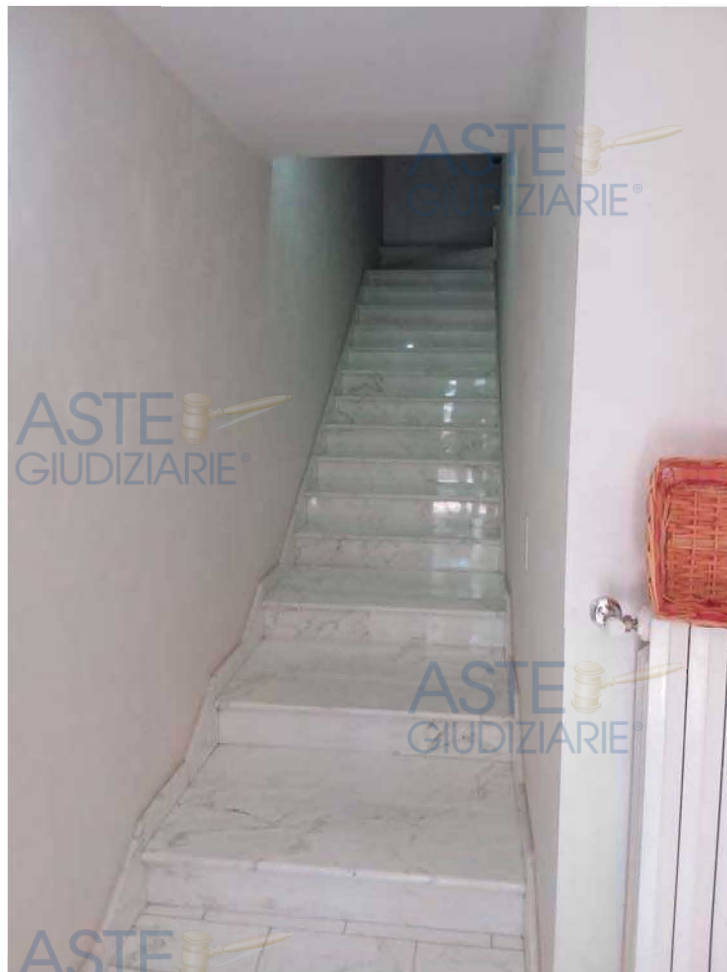
Scala interna da androne di ingresso al piano terra per accedere al piano primo
