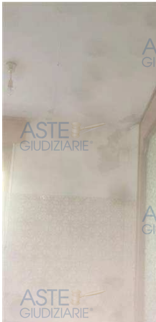
macchie di umidità diffuse
