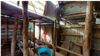
Foto 9: Catasto Terreni di Cittanova, foglio 60, particella 12 – Manufatto addossato allo spigolo nord-ovest del fabbricato contrassegnato con la lettera “c”, in cattive condizioni di manutenzione, è stato realizzato con una struttura in muratura non intonacata e tetto ricoperto da fogli di lamiera di metallo.
