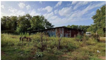
Foto 4: Catasto Terreni di Citanova, foglio 60, particella 12 – Il fabbricato contrassegnato con la lettera "b", in stato di abbandono ed in pessime condizioni di manutenzione e conservazione, adibito un tempo a stalla, è stato realizzato con una struttura in pali di legno, pareti e tetto ricoperti da fogli di lamiera di metallo.
