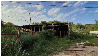
Foto 6: Catasto Terreni di Cittanova, foglio 60, particella 12 - Il fabbricato contrassegnato con la lettera "c", in stato di abbandono ed in pessime condizioni di manutenzione e conservazione, adibito un tempo a stalla, è stato realizzato con una struttura in pali di legno, pareti e tetto ricoperti da fogli di lamiera di metallo.
