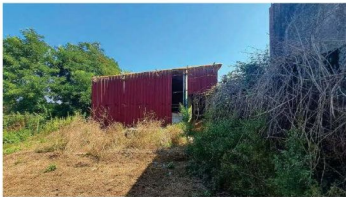
Foto 4: Catasto Terreni di Gioia Tauro, foglio 28, particella 61 – All'interno della porzione di terreno destinata a seminativo è stata rilevata la presenza dei resti di un capannone ormai inutilizzabile, identificato con la lettera "g" nell'estratto di mappa riportato nell'allegato "2" alla presente relazione
