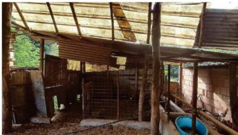
Foto 8: Catasto Terreni di Cittanova, foglio 60, particella 12 – Manufatto addossato al lato ovest del fabbricato contrassegnato con la lettera “c”, in pessime condizioni di manutenzione, è stato realizzato con una struttura in pali di legno, pareti e tetto ricoperti da fogli di lamiera di metallo e di vetroresina.
