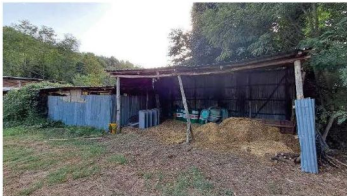
Foto 11: Catasto Terreni di Citanova, foglio 60, particella 12 – Il fabbricato contrassegnato con la lettera “d”, in pessime condizioni di manutenzione e conservazione, consiste in un manufatto adibito a deposito con annessa tettoia.
