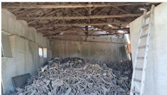
Foto 10: Catasto Terreni di Taurianova, foglio 18, particelle 12 e 13 – Fabbricato "b" - deposito in precarie condizioni di conservazione con cedimenti della struttura del tetto.
