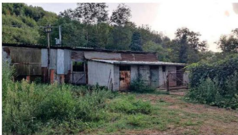
Foto 10: Catasto Terreni di Cittanova, foglio 60, particella 12 – Manufatto addossato al lato nord del fabbricato contrassegnato con la lettera “c”, in cattive condizioni di manutenzione, è stato realizzato con una struttura in muratura in blocchi di calcestruzzo e tetto ricoperto da fogli di lamiera ondulata di metallo.
