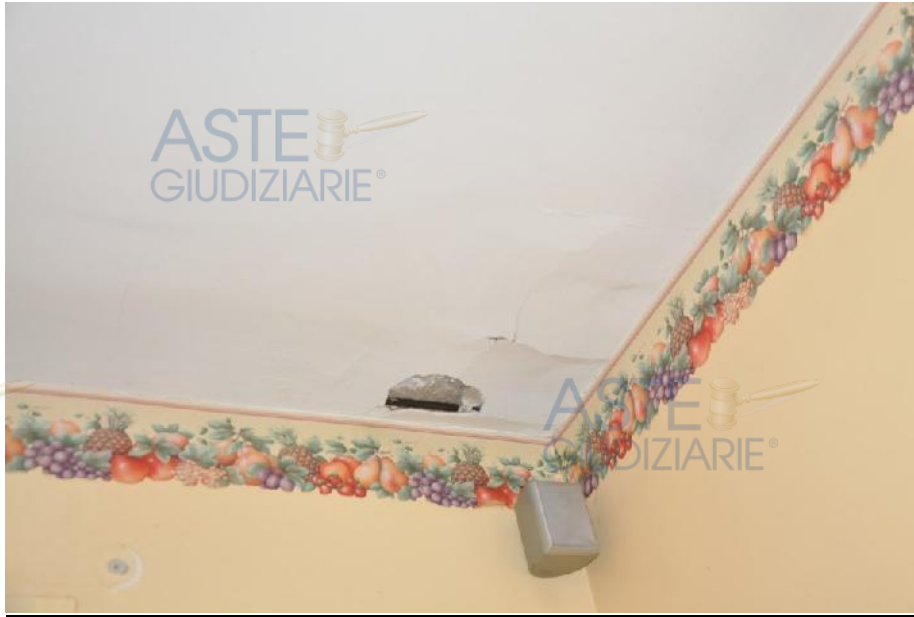
Foto 2 - Soffitto della Stanza 2 – Soggiorno/Pranzo
