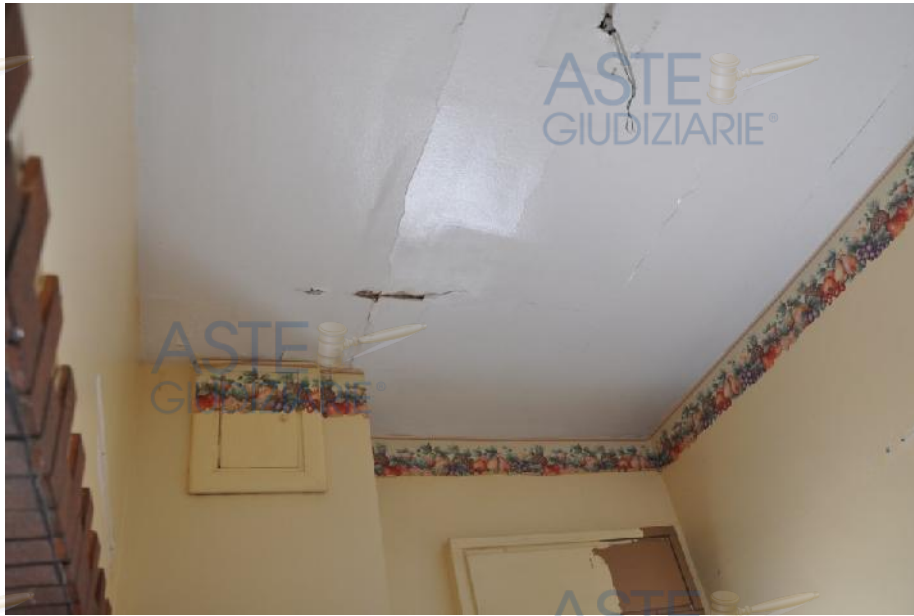
Foto 1 - Soffitto del vano cucina
