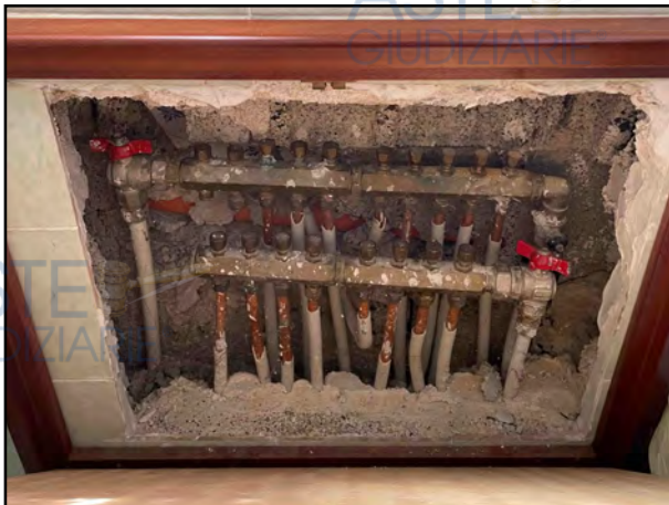
Collettori dell'impianto idrico
