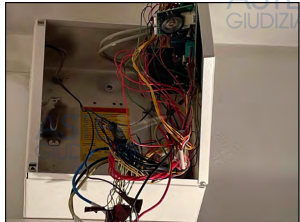
Centralina dell'impianto di allarme
