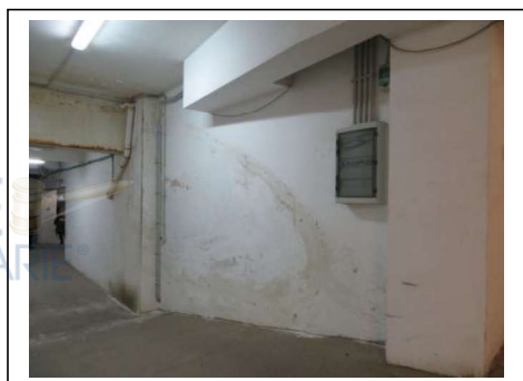
Fig. 30. Primo piano seminterrato. Degradi su una parete in prossimità della rampa di accesso dal civico 22 di via Villa Heloise
