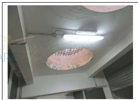
Fig. 28. Primo piano seminterrato. Degradi sul soffitto delle aree di manovra in corrispondenza dei lucernari di via Villa Heloise
