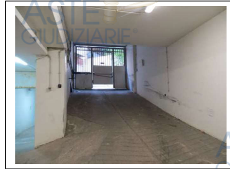
Fig. 11. Rampa del primo piano scantinato con ingresso dal civico n. 22 di via Villa Heloise
