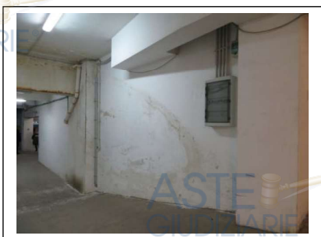
Fig. 32. Primo piano seminterrato. Degradi su una parete in prossimità della rampa di accesso dal civico 22 di via Villa Heloise
