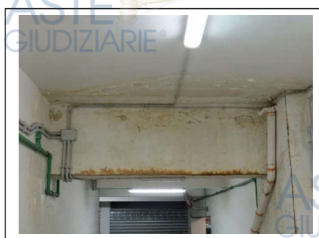
Fig. 33. Primo piano seminterrato. Degradi su una parete in prossimità della rampa di accesso dal civico 22 di via Villa Heloise
