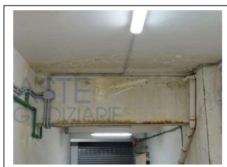
Fig. 31. Primo piano seminterrato. Degradi su una trave in prossimità della rampa di accesso dal civico 22 di via Villa Heloise
