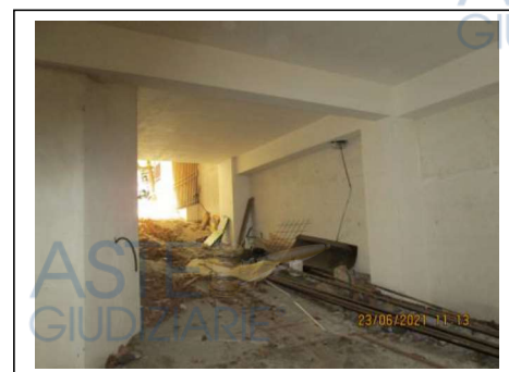
Fig.23. Rampa del secondo piano scantinato con ingresso dal civico n. 20 di via Villa Heloise
