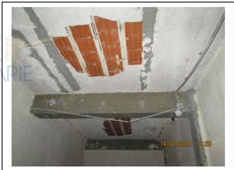
Fig. 50. Secondo piano scantinato. Soffitti sfondellati
