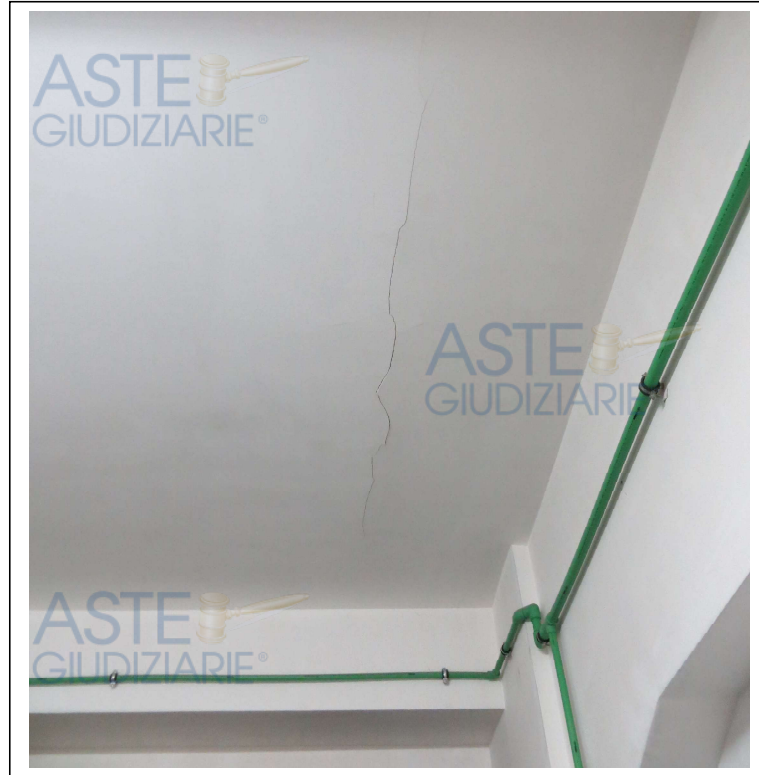
Foto 30. Soffitto del box sub. 48 con presenza di fessurazione (fotografato in occasione del sopralluogo del 14/01/2022)
