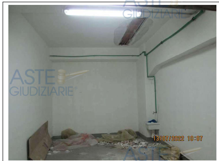
Foto 31. Soffitto del box sub. 48 con porzione dell'intradosso sfondellata in corrispondenza della pregressa fessurazione (fotografato in occasione del sopralluogo del 13/07/2022)
