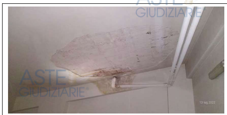
Foto 29. Soffitto del box sub. 42 con aloni di umidità attorno alla tubazione proveniente dal piano superiore e distacco di vasta porzione dell'intonaco dell'intradosso (fotografato in occasione del sopralluogo del 13/07/2022)
