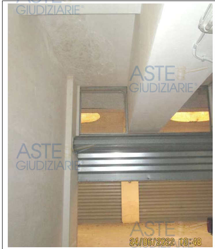
Foto 7. Box sub. 34. Degradato sulla porzione di soffitto più vicina all'ingresso
