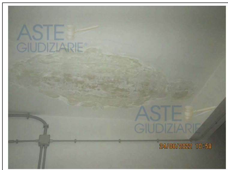
Foto 8. Box sub. 36. Degradato sulla porzione di soffitto più vicina all'ingresso
