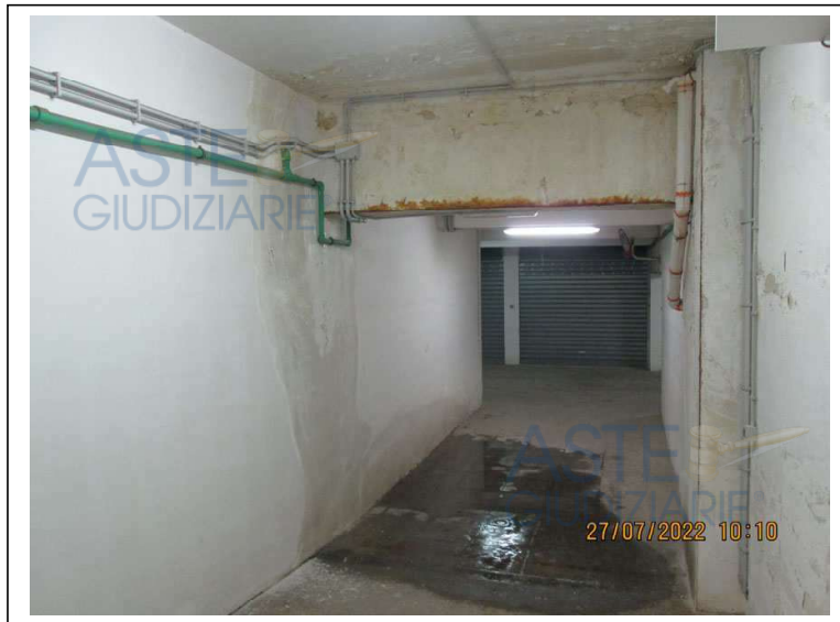
Foto 32. Trave ammalorata della corsia comune compresa tra il box sub. 37 e il box sub. 38. E' visibile presenza di acqua sulla parete del box sub. 37, sulla trave e sul pavimento
