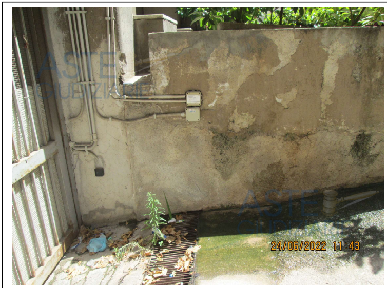
Foto 27. Griglia ostruita con detriti e fogliame davanti al cancello di ingresso della rampa dal civico n. 22 di via Villa Heloise
