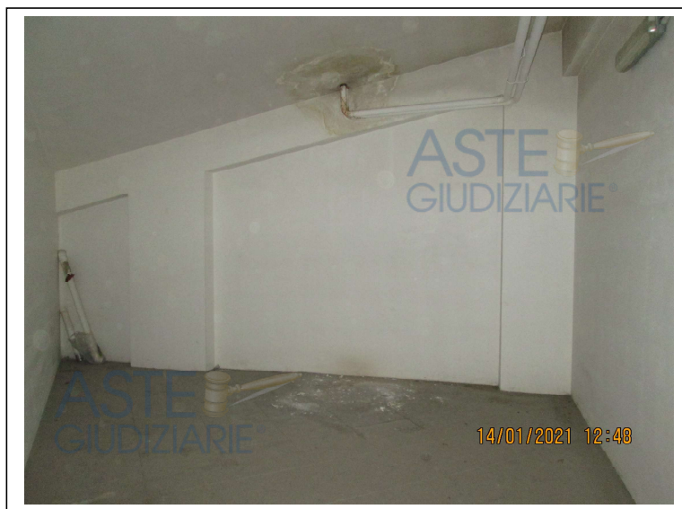
Foto 28. Soffitto del box sub. 42 con aloni di umidità attorno alla tubazione proveniente dal piano superiore (fotografato in occasione del sopralluogo del 14/01/2022)
