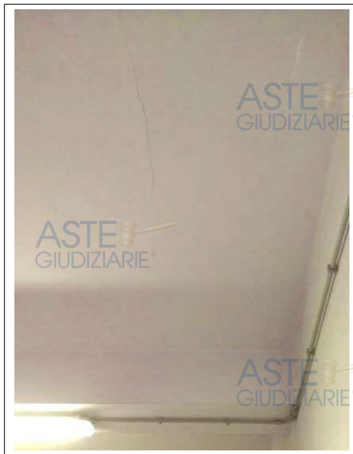
Foto 16. Box sub. 44. Fessurazione dell'intradosso
