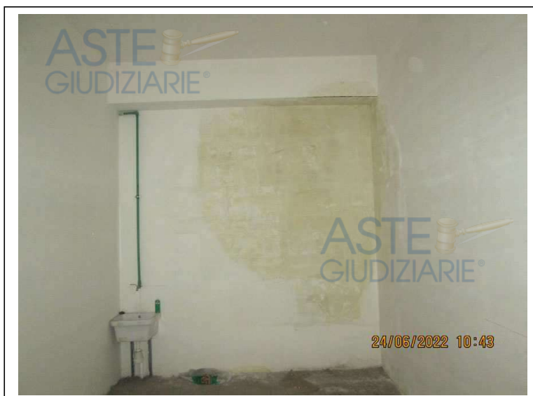
Foto 4. Box sub. 33. Degradi sulla parete di fondo e sulla trave
