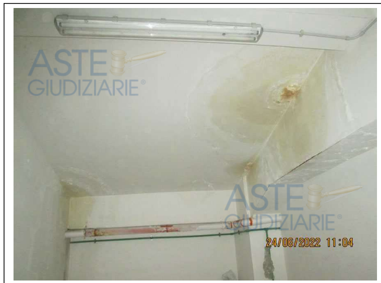
Foto 12. Box sub. 38. Degradi sul soffitto e sulla trave
