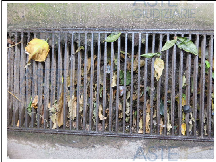
Foto 26. Griglia ostruita davanti al cancello di ingresso della rampa del civico n. 22 di via Villa Heloise
