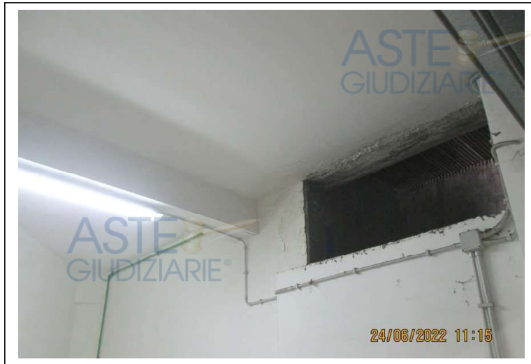
Foto 15. Box sub. 41. Sfogliamenti e sfarinamenti della tinteggiatura lungo il perimetro di una apertura
