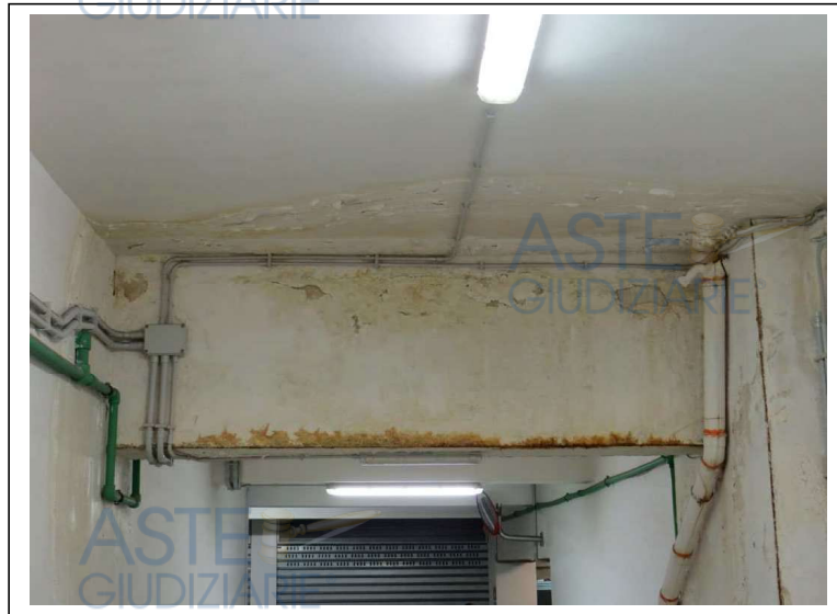
Foto 19. Trave ammalorata della corsia comune compresa tra il box sub. 37 e il box sub. 38
