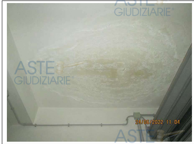
Foto 11. Box sub. 38. Degradi sulla porzione di soffitto più vicina all'ingresso
