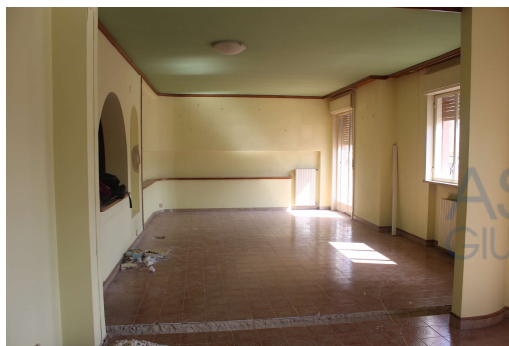
Salone pari a tre vani con accesso su balcone esposto sulla villetta condominiale (Vano 2)
