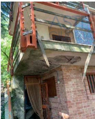
Particolare danneggiamento solaio parti aggettanti
