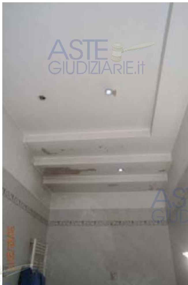
Foto n° 22 Particolare Controsoffitto Bagno.
