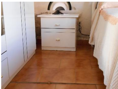
Foto n.23: umidità e lesioni sul pavimento
