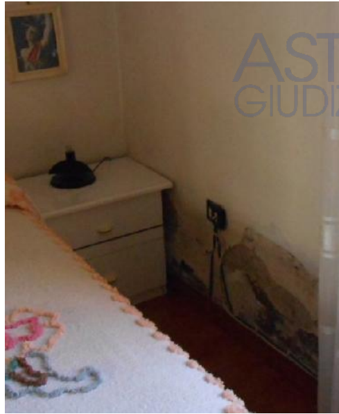
Foto n. 26 : Umidità nella camera da letto
