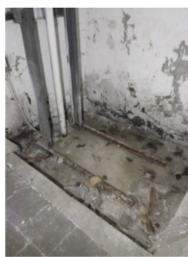
Foto n. 58 - Base n. 4 - montacarichi di collegamento con il Base n. 1 sub 5f
