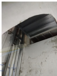
Foto n. 59 - Base n. 4 - montacarichi di collegamento con il Base n. 1 sub 5f
