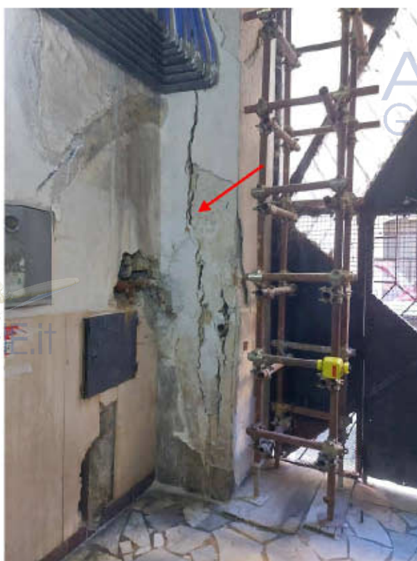
atrio - particolare lesioni muratura e struttura di puntellamento
