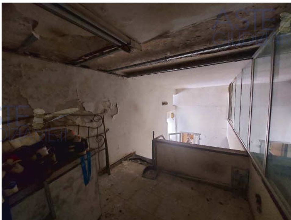
Part. piano soppalco – evidenti tracce di fenomeni infiltrativi sul solaio del disimpegno
