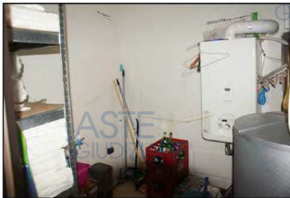
Depositi/ centrale termica
