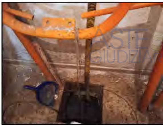
Stanza n. 7 Pozzo d'acqua con pompa di sollevamento
