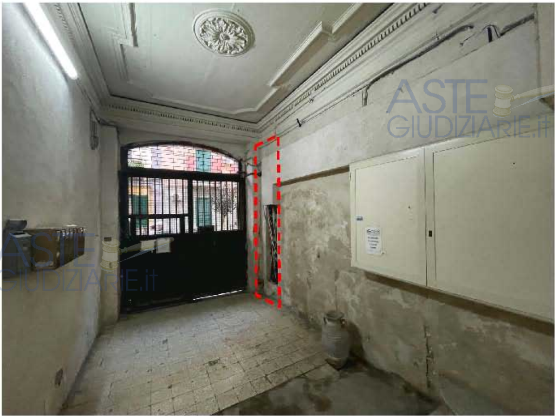
Androne del fabbricato. Si evidenzia la porzione di parete a confine con il bagno dell'immobile staggito
