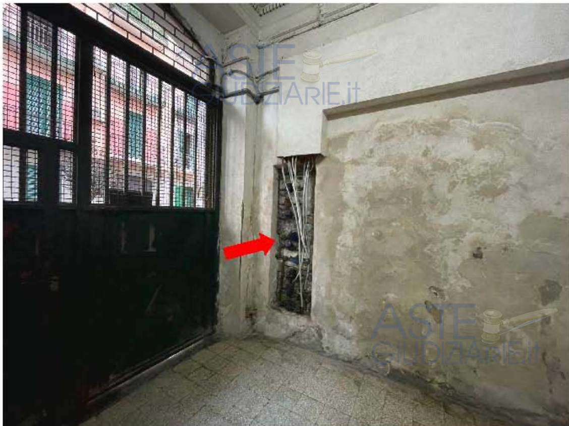
Androne del fabbricato. Si evidenzia la presenza dei contatori dell'acqua dei condomini.
