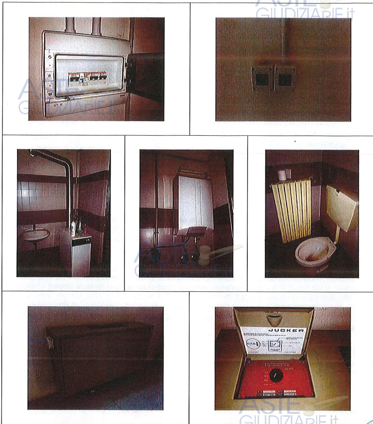
Fig. 10: Impianti in dotazione all'immobile
