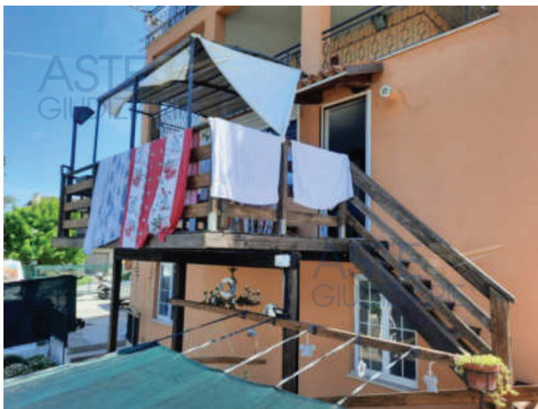
Foto n. 19 sub 7 terrazza oggetto di Ordinanza di Demolizione
