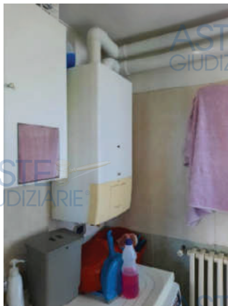
Foto n. 16 SUB 7 Bagno con generatore di calore
